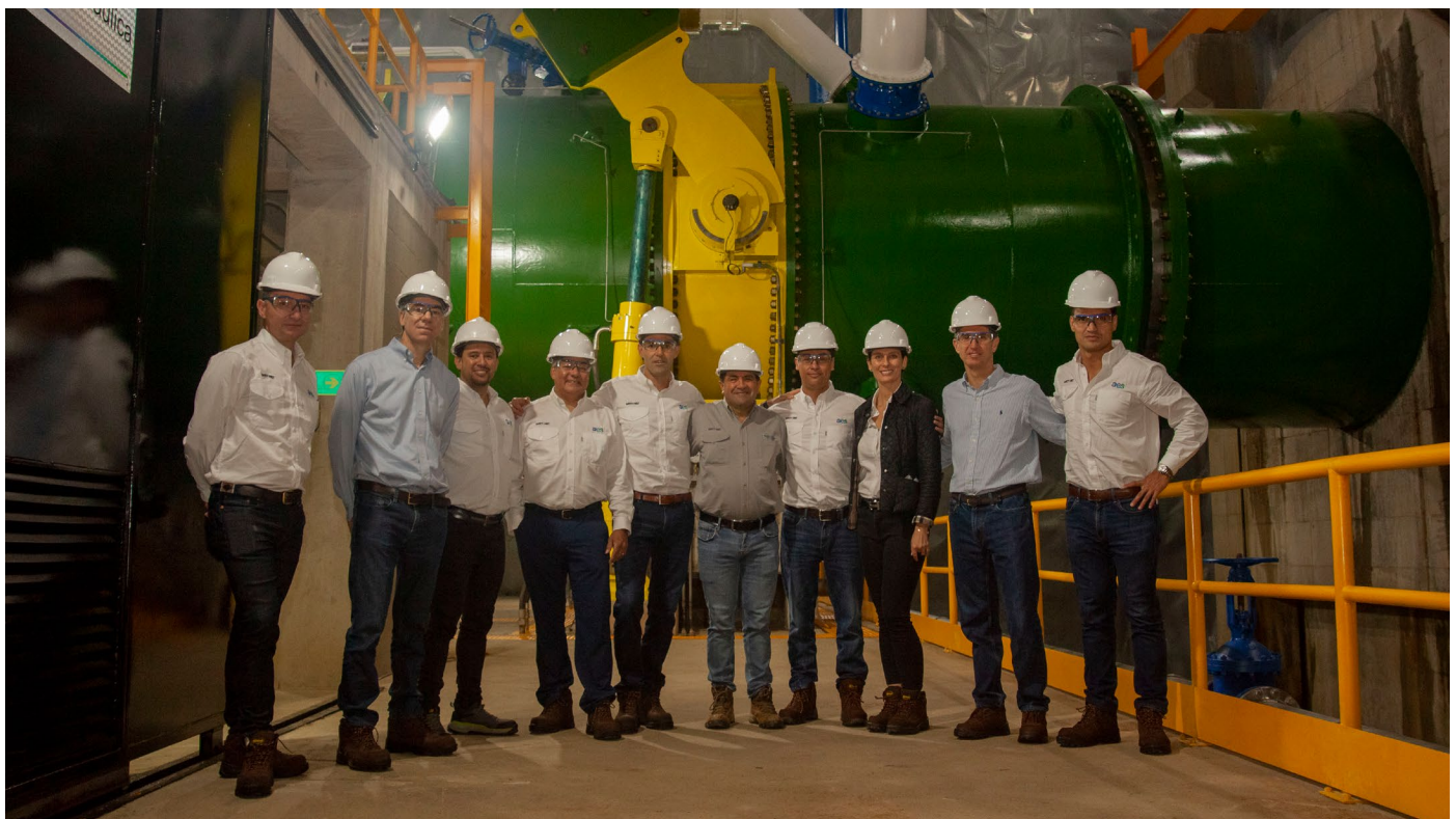
Cámara de válvulas - ramal de conexión 1 Fuente: AES Colombia, septiembre de 2022.
