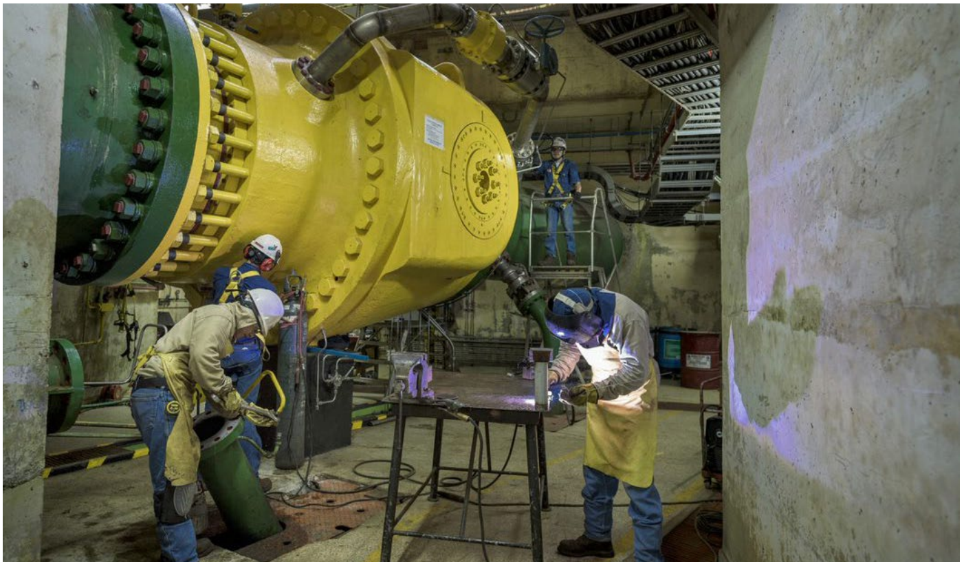
Casa de Máquinas, Central Chivor Fuente: AES Colombia, diciembre de 2022.
